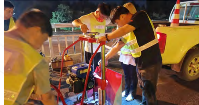
2022年郑州分公司路面修复养护工程施工XZLM-2沥青路面芯样钻取自检
